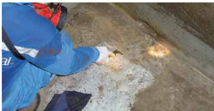
Chapa rugosa no fundo de um tanque de petróleo bruto, após 6 anos em serviço. Apesar da presença de sujeira e manchas de óleo, o Intershield® 300 ainda continua em excelentes condições
