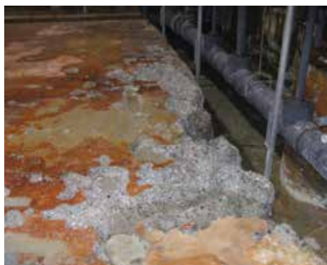
Beton aangetast door agressieve chemicaliën
